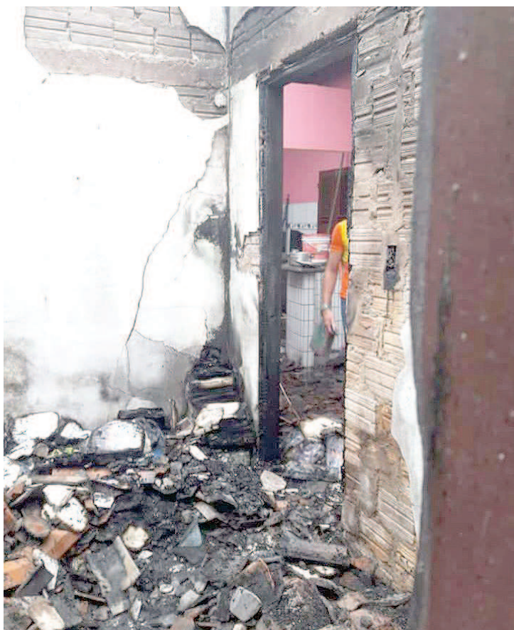
A edificação foi destruída pelas chamas que mataram o professor
