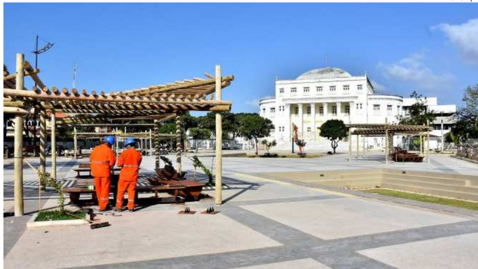
Reforma da Praça do Pantheon está entre as obras de requalificação urbanística do Centro
