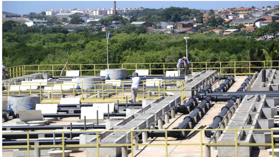
ESTAÇÃO DE TRATAMENTO NO VINHAIS. SANEAMENTO BÁSICO TEM ÍNDICE FRÁGIL
