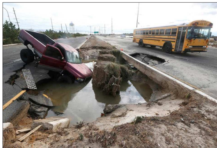
EROSÕES: O envelhecimento das infraestruturas de transporte não se misturará bem às condições climáticas extremas. Grandes tempestades e condições meteorológicas extremas já mostraram sua força. O impacto nas redes de transporte não será bonito e o nível de destruição da supertempestade Sandy em 2012 poderá se repetir.
