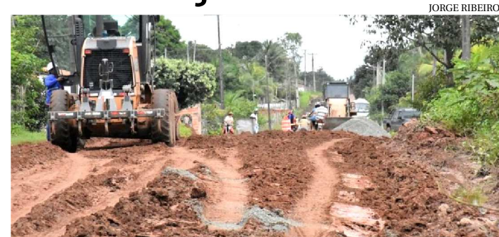
O INVERNO FOI TÃO RIGOROSO QUE DANIFICOU A ESTRADA
