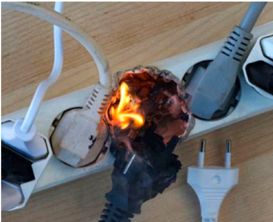
SEGURANÇA COM ENERGIA ELÉTRICA
