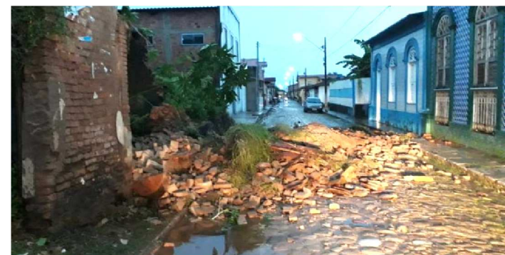
CASARÃO DESABOU NA CIDADE DE VIANA NA ÚLTIMA SEGUNDA
