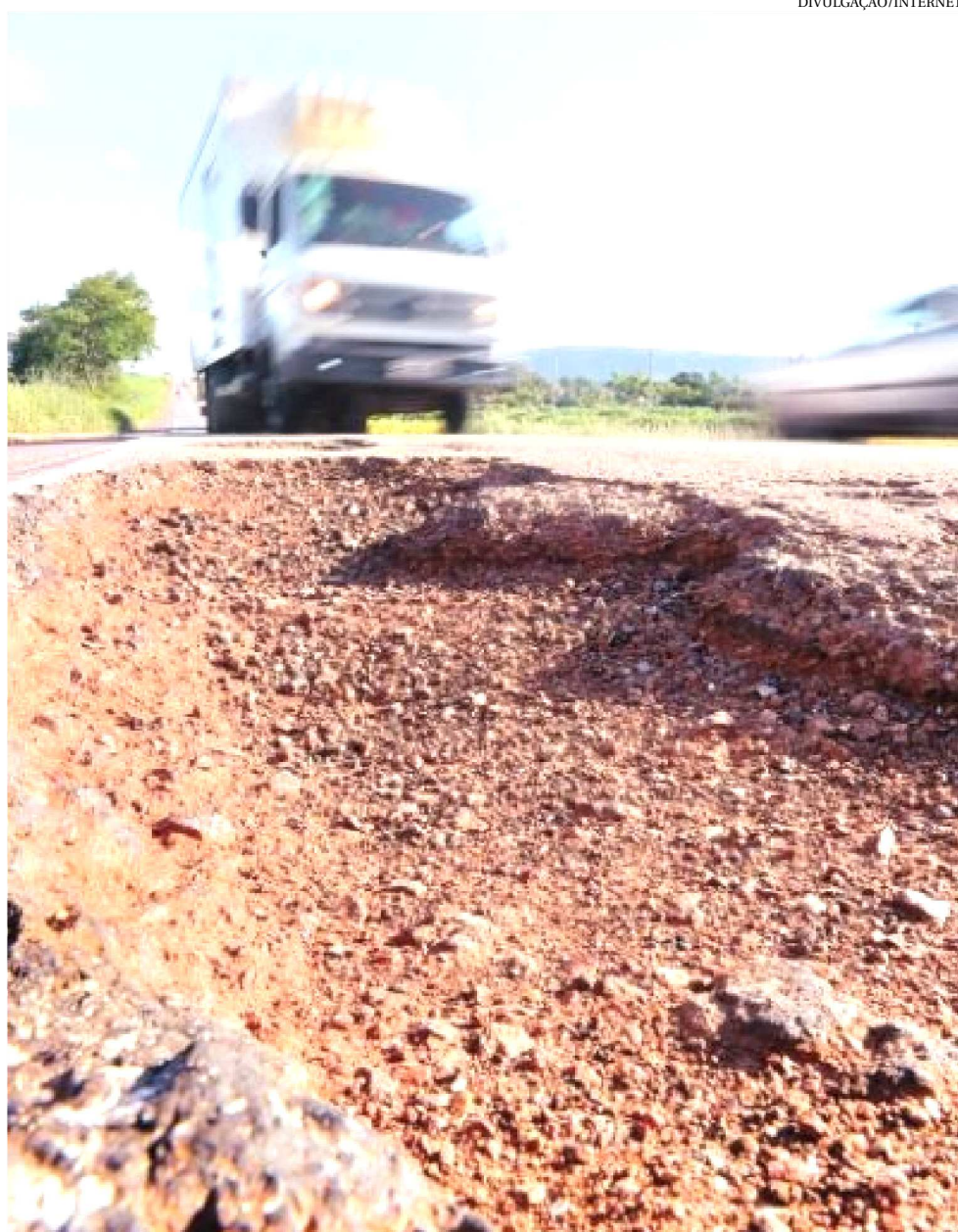
EM 2019 HOUVE UMA PIORA NA MALHA PAVIMENTADA DAS ESTRADAS DO ESTADO
