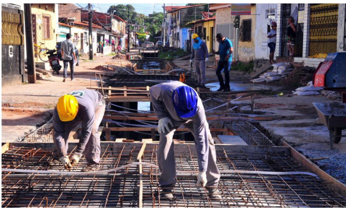
Prefeito Edivaldo vistoria obra de urbanização da Rua da Felicidade, no João Paulo
