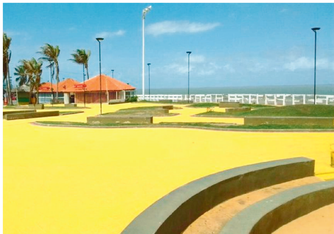
FOI OBSERVADO O DESMORONAMENTO PARCIAL DA MURETA DO TEATRO DO PARQUINHO
