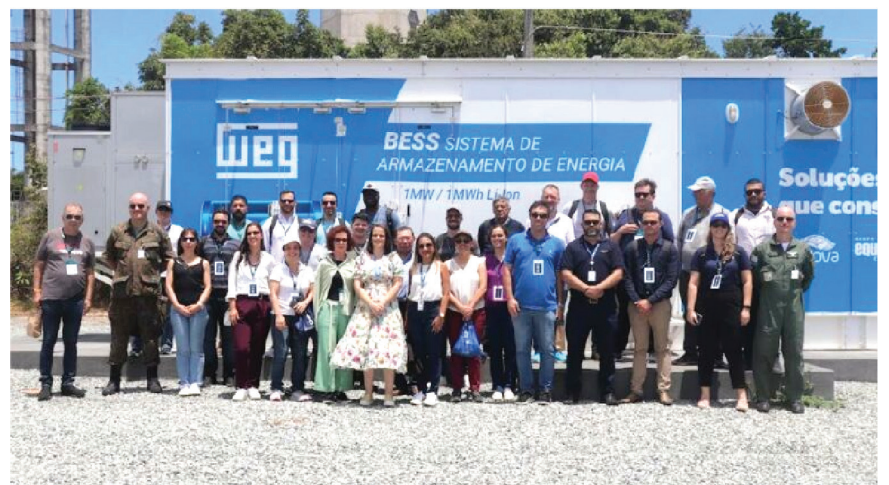
A iniciativa é pioneira no Brasil e consiste em uma rede elétrica inteligente e de grande potência, que atende as demandas de energia durante os lançamentos de satélites e foguetes, do Centro de Lançamento de Alcântara (CLA), no Maranhão.
