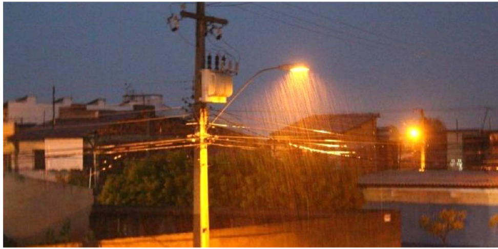
EM ÁREAS EXTERNAS, COMO RUAS E AVENIDAS, O PERIGO É AINDA MAIOR
