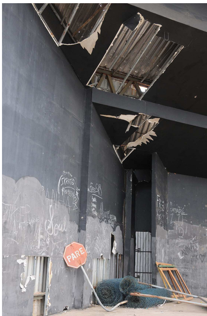
Parte do teto já desabou e as paredes estão pinchadas por vândalos
