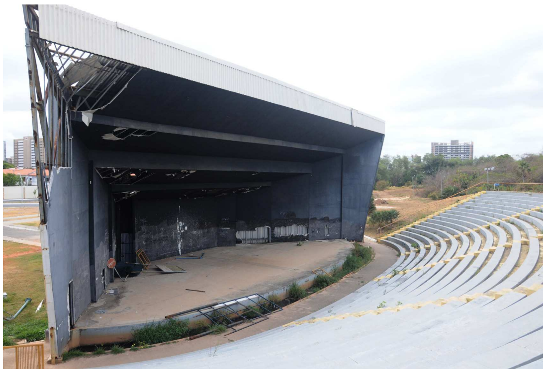
Abandonada, Concha da Lagoa da Jansen está com a sua estrutura completamente comprometida
