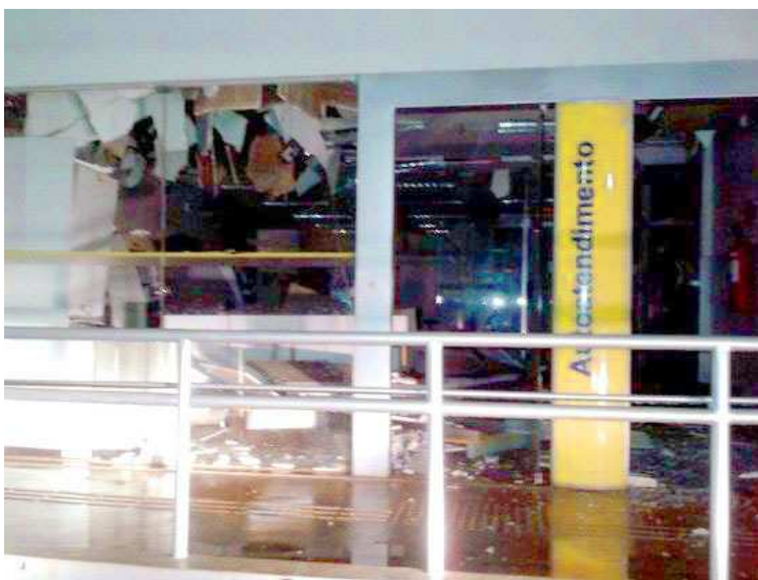
Com a força da explosão, estilhaços de vidro ficaram espalhados por todos os lados da agência em Paraibano
