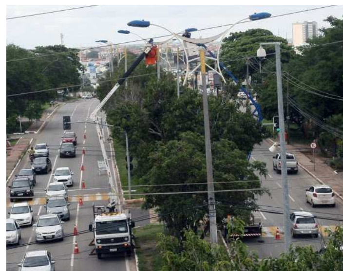
Prefeitura entrega nova iluminação nas avenidas de São Luís
