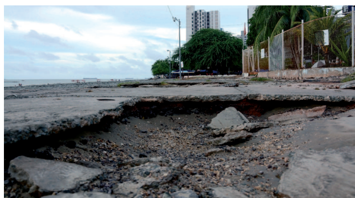
Parte do calçadão está comprometendo o passeio público no local
