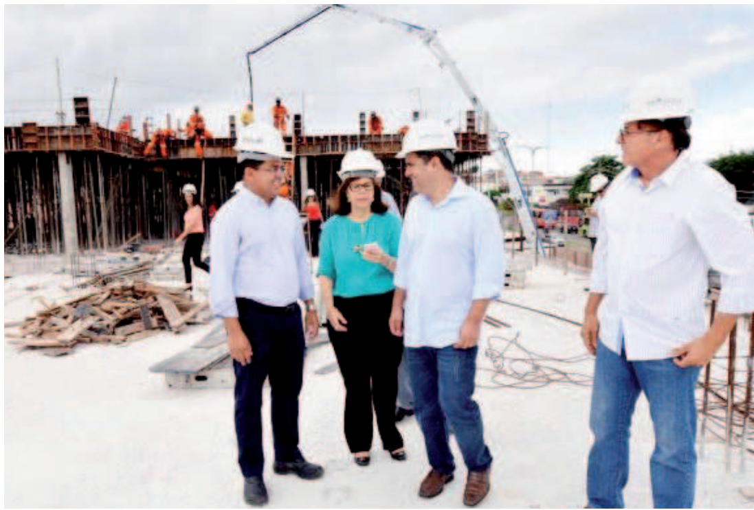
Prefeito e secretários na obra do novo Hospital da Criança, feita por meio de uma parceria com o estado
