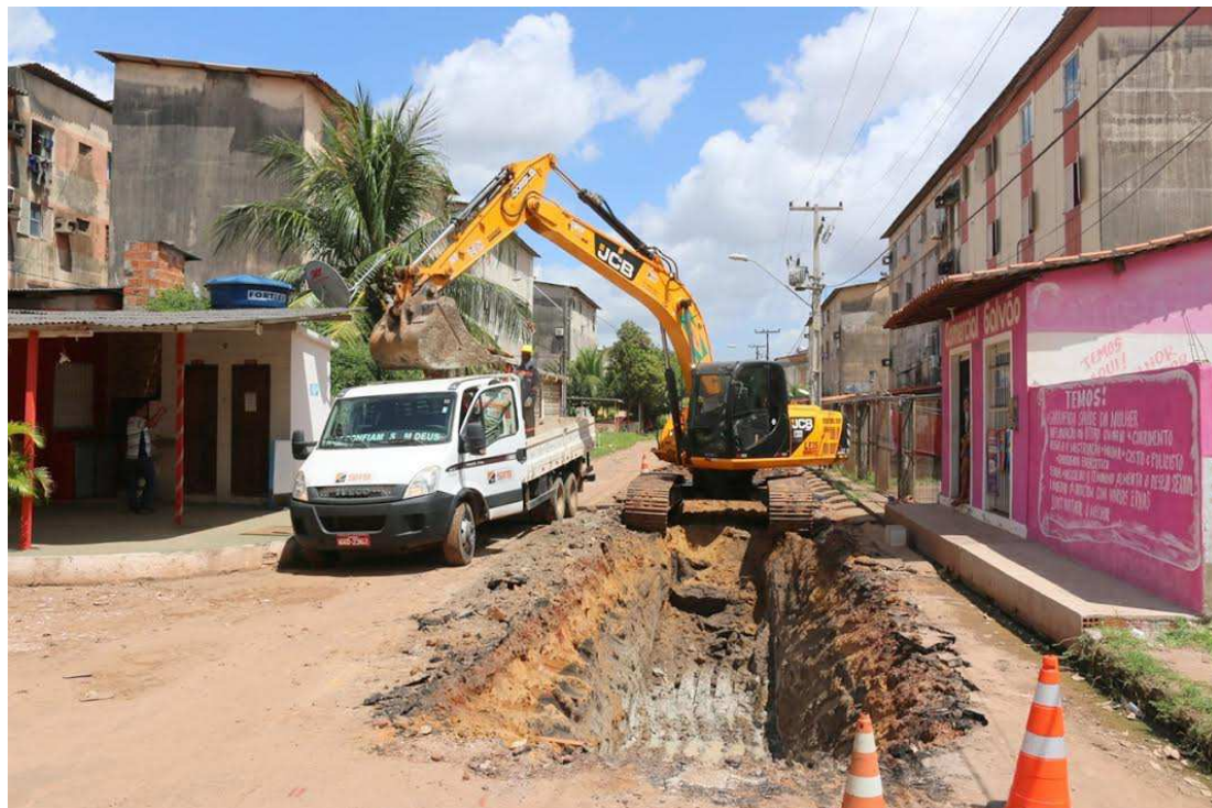
Máquinas estão fazendo drenagem profunda no bairro para evitar alagamento durante o período de chuvas
