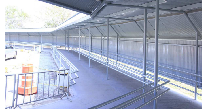
A obra integra a primeira etapa do projeto de melhorias do terminal
