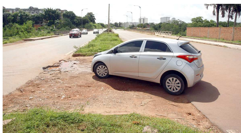
Canteiros são quebrados para facilitar manobras irregulares
