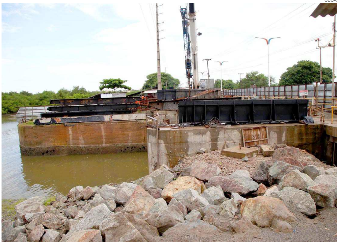
Dois das três etapas já foram concluídas, incluindo a instalação de uma comporta nova e a recuperação de outras três
