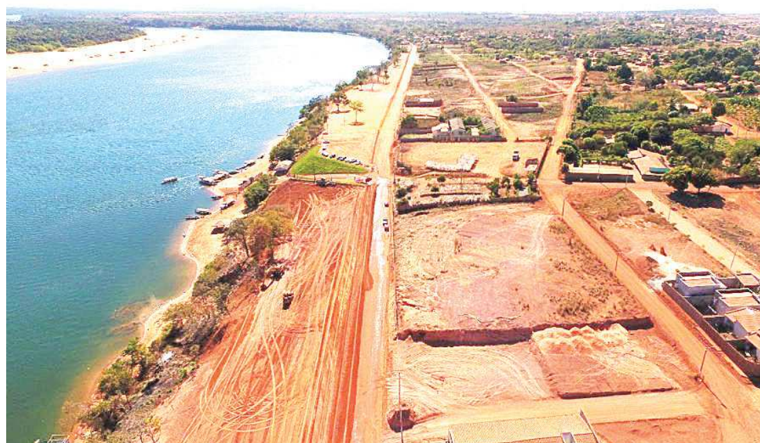
Novo Sistema Italuís e da Beira-Rio, em Imperatriz, fazem parte do pacote de obras que serão entregues
