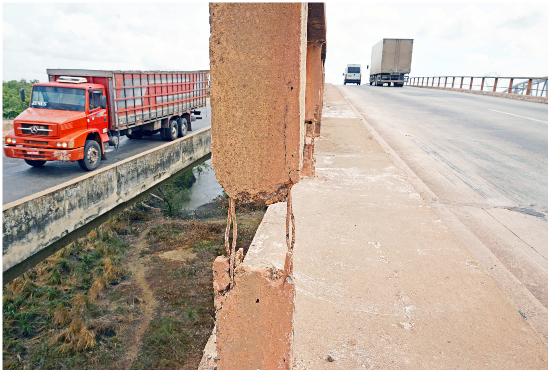
Na parte de cima da ponte alguns problemas ainda são percebidos, como na estrutura e buraco no asfalto
