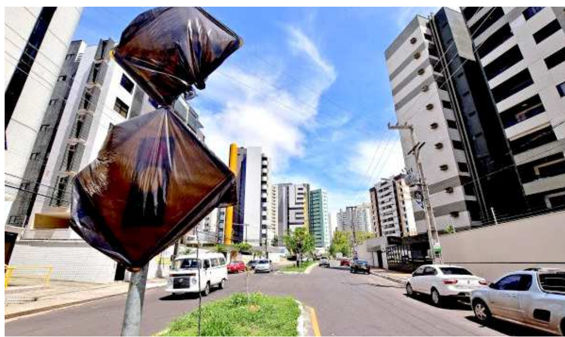
Semáforo será instalado no cruzamento entre a Rua Mitra e a Avenida do Vale, no Renascença II
