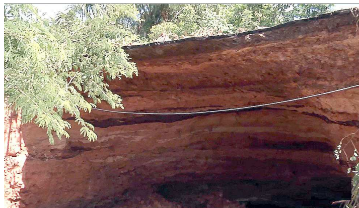
Motoristas que precisam passar no local estão utilizando outras vias
