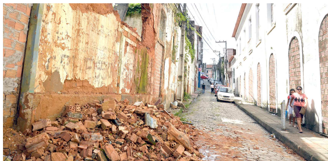
Parte de um prédio histórico desaba na Rua do Sol e destroços ficam atrapalhando o trânsito da via
